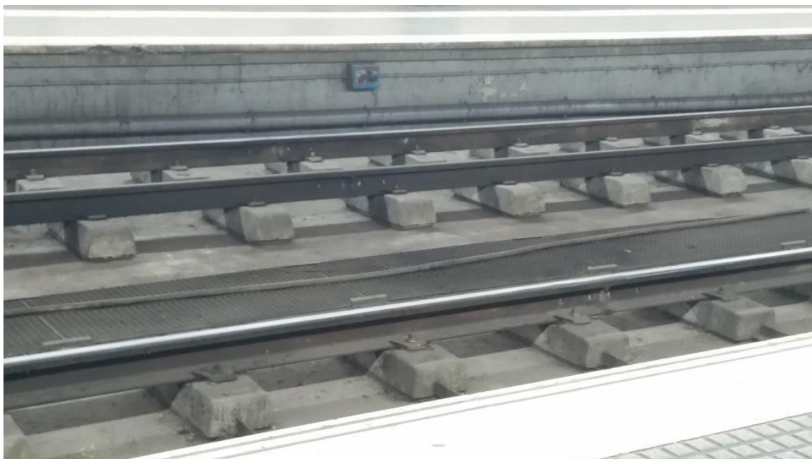
Ovan: Ballastfritt spår på Pl. Espanya. Foto: Sven-Åke Eriksson.
